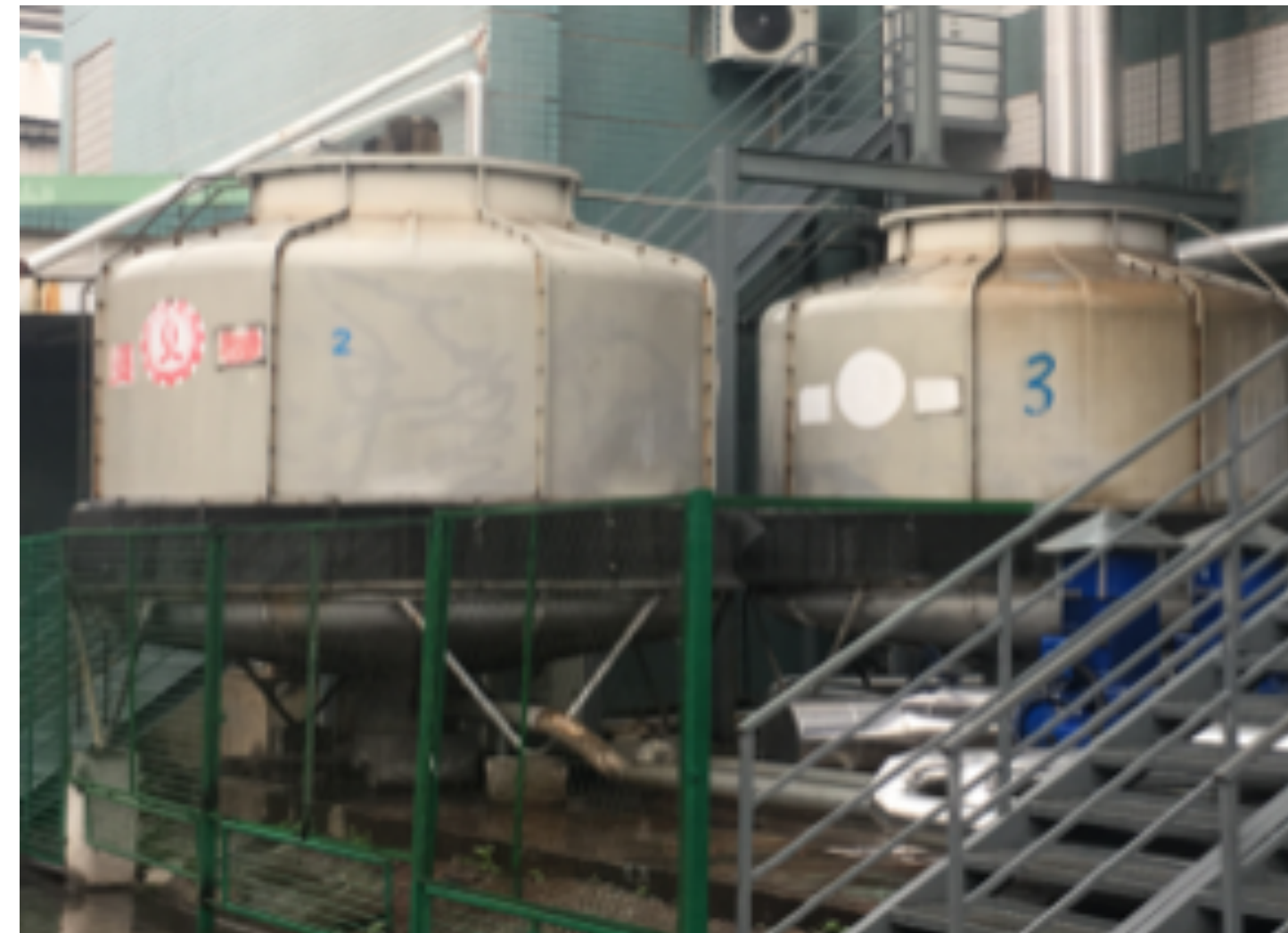
圖示說明：回收水處理冷卻系統
